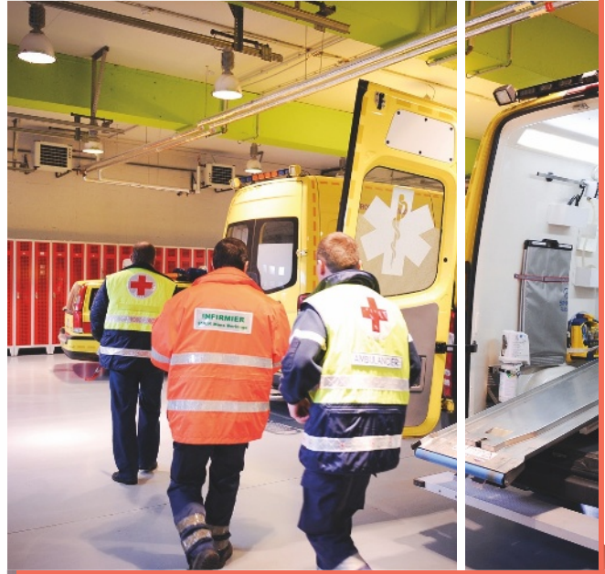
Le service dispose d'un spacieux sas pour l'entrée des ambulances et du SMUR.
